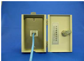
写真：プレートは、パナソニック電工の 型番WN7601Kを使用
